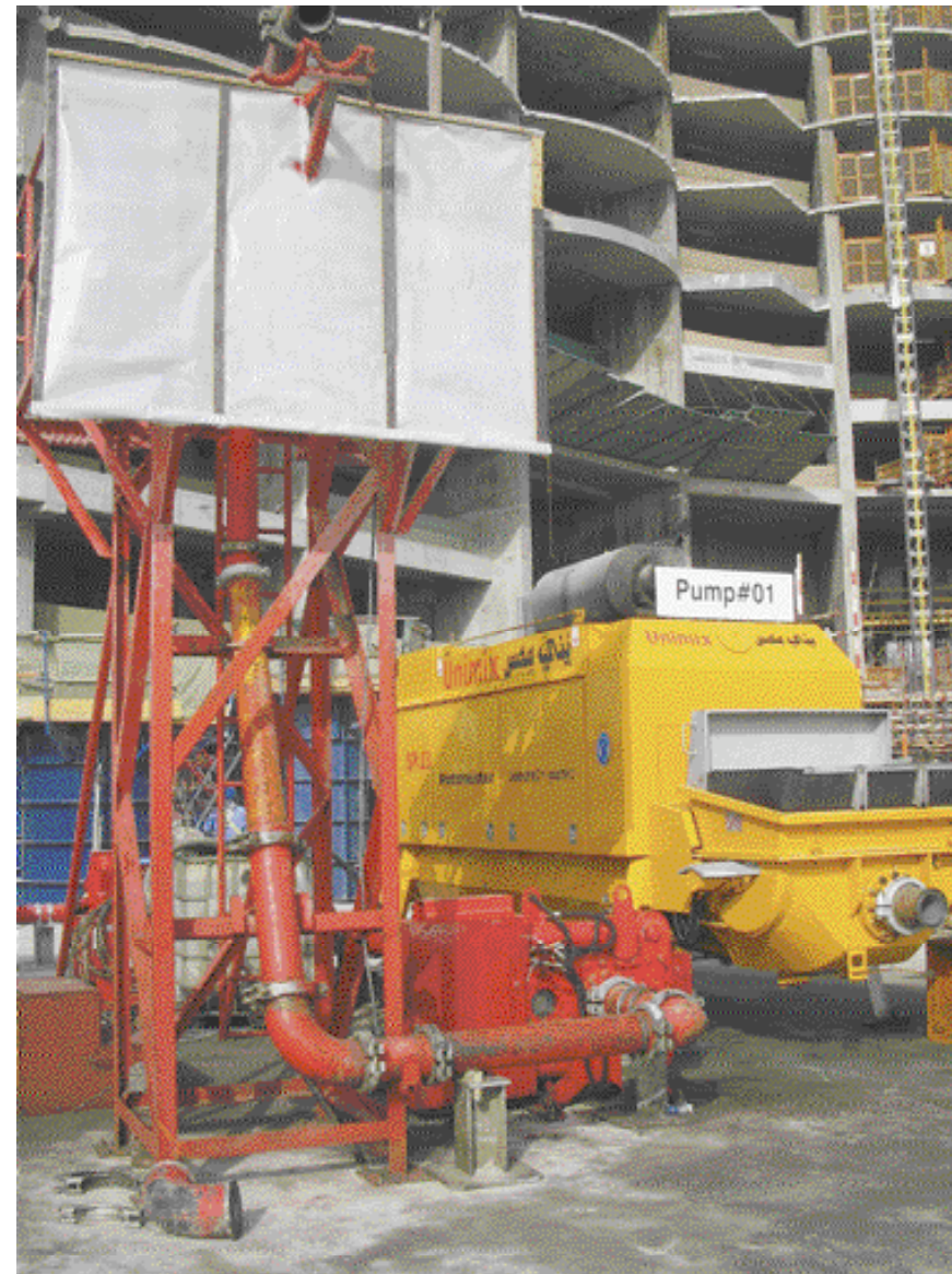
Aufbau der Reinigungsstation: Rechts eine der PM Superhochdruck-Betonpumpen, in der Mitte ein Sperrschieber mit 90° Rohrbogen, der entweder für den Pumpbetrieb an den Druckstutzen der Betonpumpe angeschlossen wird, oder bei der Reinigung die Verbindung zum Reinigungsturm herstellt
