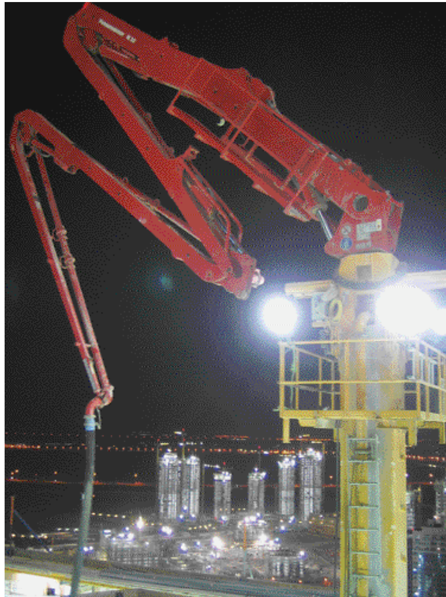
Die nicht ballastierten Putzmeister MX-Maste behindern weder rückwärtige Wände noch Kräne auf der Schalung
