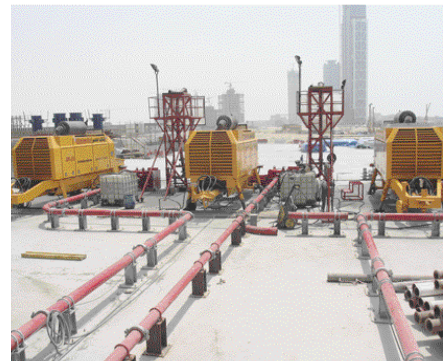
Überblick über die Anordnung der Förderleitungen an der Pumpstation – links und rechts die beiden Superhochdruck-Pumpen BSA 14000 SHP D
